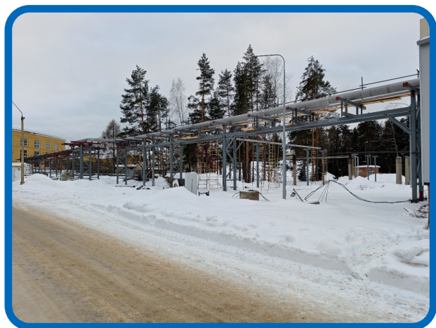
Рис. 16. Эстакада с технологическими трубопроводами криогенного комплекса. Fig. 16. The pipe rack with technological pipelines of the cryogenic complex.
