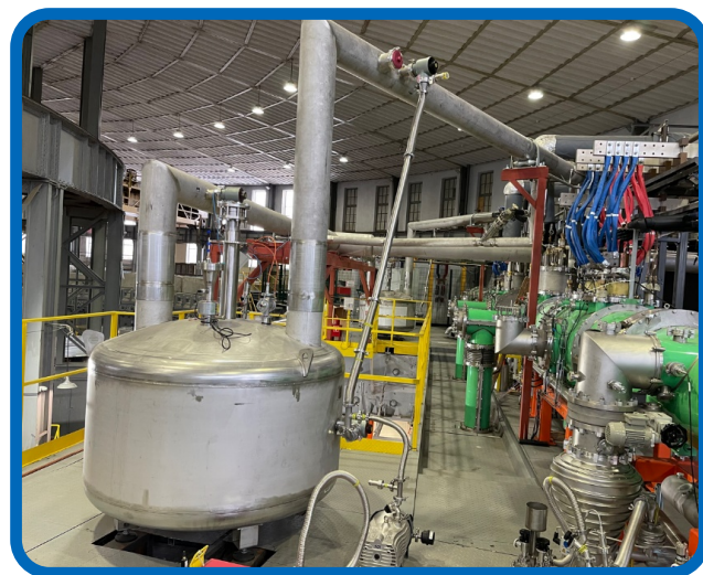
Рис. 13. Гелиевый сепаратор и криогенные трубопроводы Бустера. Fig. 13. The helium separator and cryogenic pipelines of the Booster.
